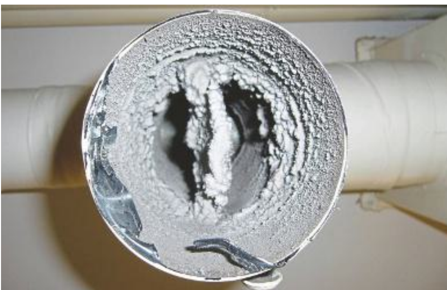
Regelmäßige Inspektionen und die Reinigung von RLT-Anlagen verhindern das im Bild gezeigte Ausmaß an Verstopfung und Ansammlung von Pollen, Keimen und Bakterien.
