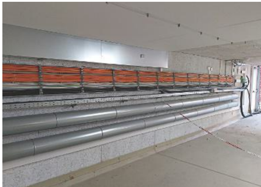
Die Anlage konnte wegen Platzmangel nicht unmittelbar am Hauswassereingang installiert werden. Hersteller und Hotelbetreiber passten die Technik-Infrastruktur für den Betrieb der Kalkschutzanlage praxistauglich an.
