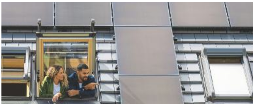
Solaranlagen sollten im Frühling auf Schmutz und defekte Teile gecheckt werden.
