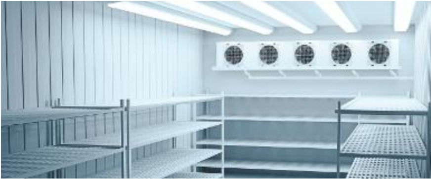
Seit 1. März gibt es wieder BAFA-Förderung für gewerbliche, hochenergieeffiziente Kälte- und Klimaanlage.
