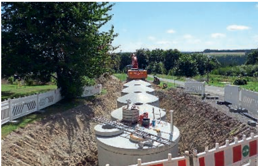
Beispiel 1, Eßbach/Thüringen. Fassungsvermögen von 100 m 3 in fünf Behältern, die untereinander durch Rohre verbunden sind.
