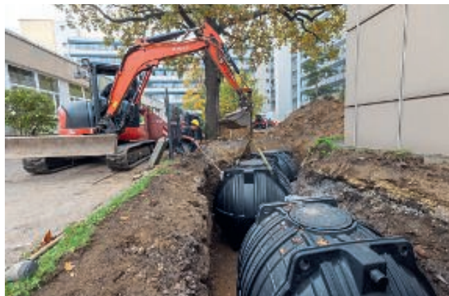
Roth bietet komplette Paketlösungen für die Regenwassernutzung zum Erdeinbau oder zur oberirdischen Aufstellung an, wie hier am Dresdener Semper-Gymnasium.
