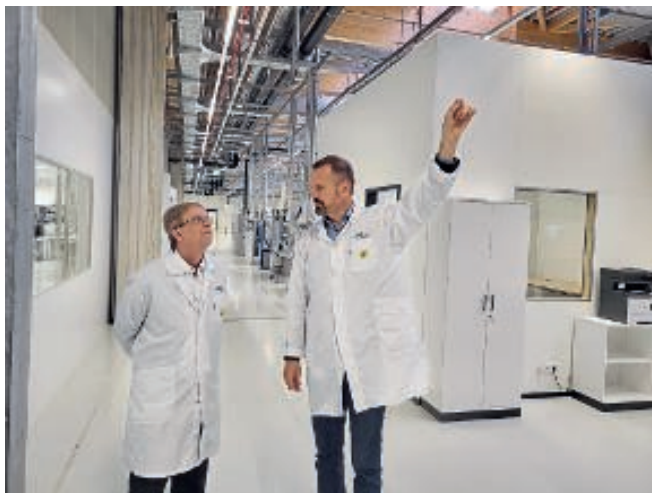
Die Versorgungsleitungen werden komplett in einer Deckenebene geführt. Im Hintergrund rechts ist der in die Halle integrierte Bürotrakt zu erkennen; links vom Gang befindet sich der Reinraum.
