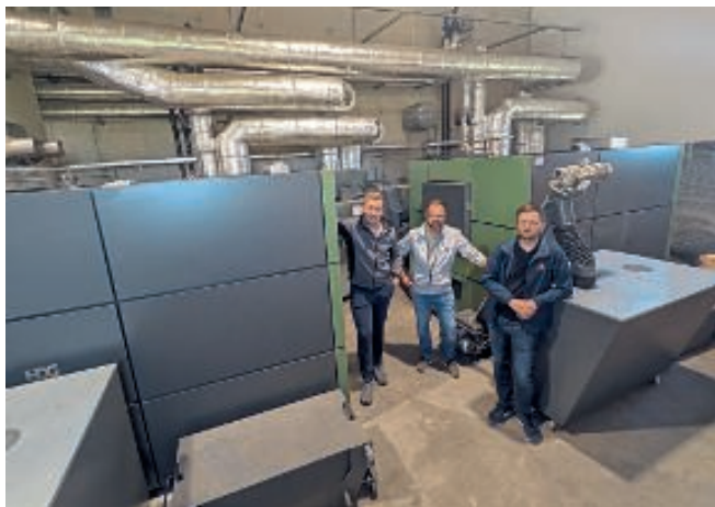
Im Heizraum der neuen Zentrale: Andreas Strobel, Gesellschafter von Strobl Heizungsbau, Maximilian Maier, Forstunternehmer und Nahwärmenetzbetreiber, und Thomas Moser, Produktmanager bei HDG Bavaria.
