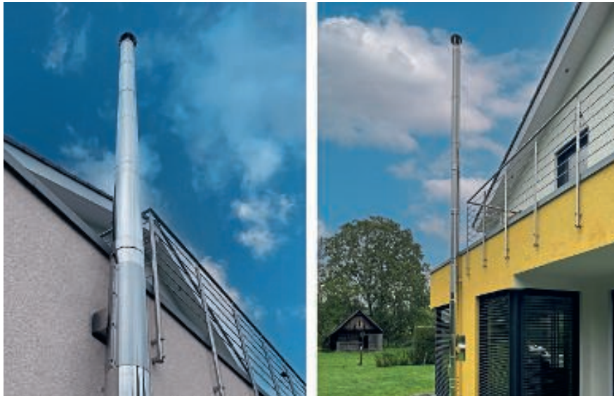
Abgasanlagen von Festbrennstoff-Feuerstätten müssen, wenn sie neu errichtet werden, Anforderungen an die Lage der Mündung und die Höhe über Dach einhalten.
