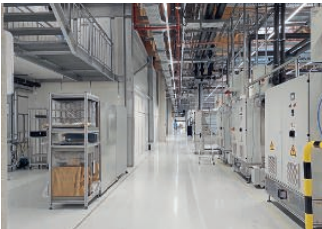
In der Halle befindet sich der Reinraum mit seinen zwei Etagen.
