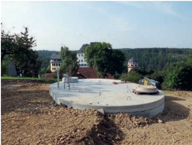
Beispiel 2, Burgk, Stadt Schleiz/Thüringen. Unterirdischer Löschwasserbehälter aus Betonfertigteilen, 100 m³ Fassungsvermögen.
