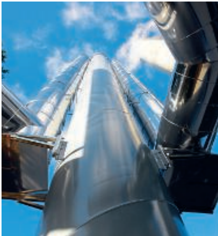
Freistehende Abgasanlage mit Tragkonstruktion nach DIN EN 13084-1 und DIN EN 13084-8.
